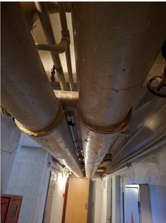
Pátevní rozvod pod stropem 1PP - Okruh Ohřev – TV bez tepelné izolace
